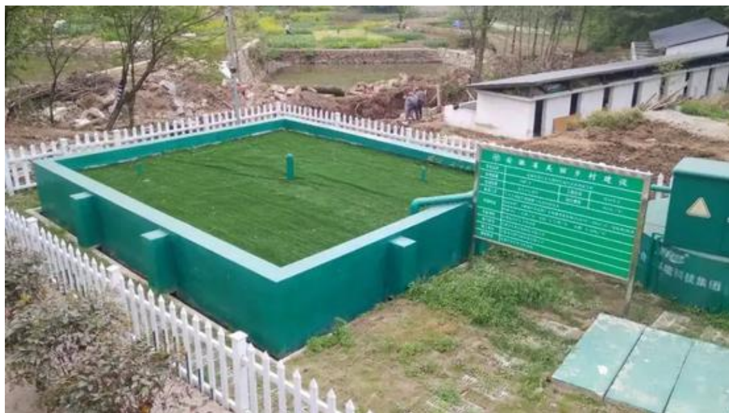
图 4.1-4 农村生活污水处理站实景图
